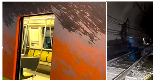
Figura 4. Filtraciones hacia el túnel de la línea 12 del metro (Uribe, 2024).
