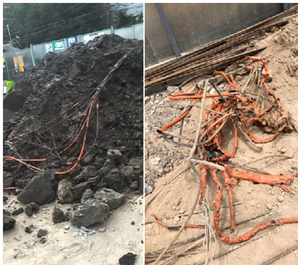
Figura 7. Anclas de cable de presfuerzo de vecinos, encontradas durante la excavación de un muro Milán y durante la perforación de pilas de cimentación.
